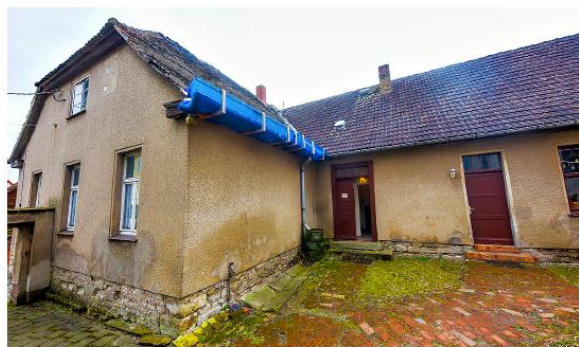
Das baufällige Dach der alten Schule in Raßnitz kann nun saniert werden.
